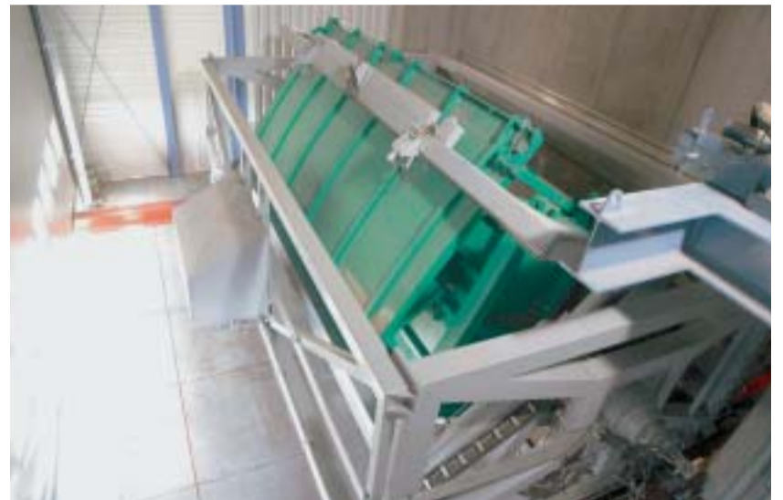
Automatische Entleerung eines Containers in den Müllbunker.
